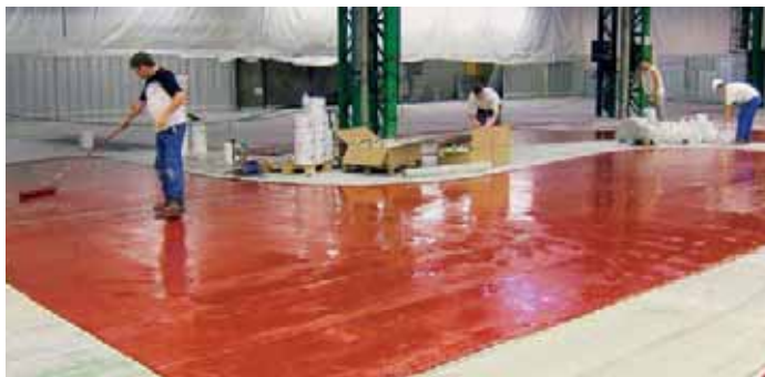
LE DOCUMENT CONTRACTUEL lancé par l'AFFAR permettra de définir précisément les sollicitations auxquelles seront soumis les revêtements sols industriels.
